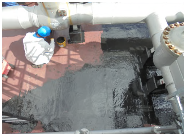
Unsere Referenz in Schwedt/O (Deutschland): Mineralölverbundleitung GmbH
