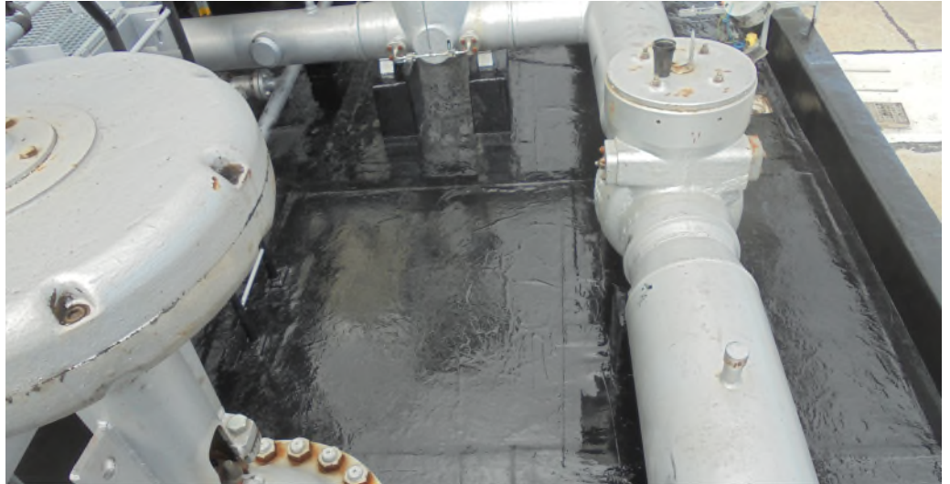
Unsere Referenz in Schwedt/O.(Deutschland): Mineralölverbundleitung GmbH
